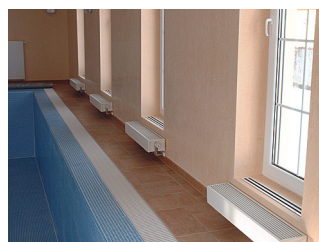
A légfűtést a fűtőszerelelő (terv nélkül) „megfejelte” radiátorokkal. A többlet fűtési teljesítményre nincs szükség, viszont az éles felületek, sarkok nagy balesetveszélyt jelentenek!
