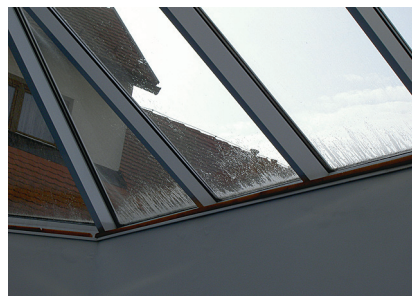
Nincs légszatorna kiépítve, így a felülvilágító üvege mindig párás. A gyenge minőségű mozgó szerkezet átlag élettartama 3-4 hónap
