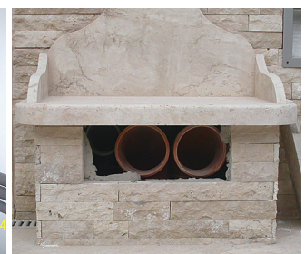
A friss- és használtlevegő-csatornák közelsége rövidzárat okoz. Az eredetileg ide szerelt díszrács ezt még fokozta, majd valaki még egy üveglakot is helyezett elé!
