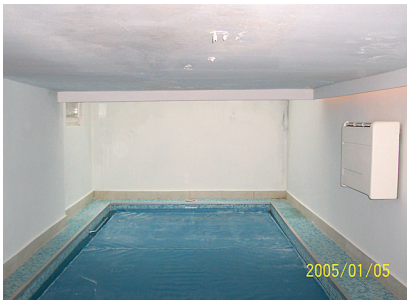
Hőszigetelés nélküli terasz alatti uszoda mennyezete a hőhid miatt ledobja a penészes vakolatot
