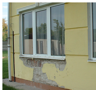
A páratlanítás teljes hiánya miatt a falszerkezet átázott, az ablakok kinyithatatlanul elvetemedtek
