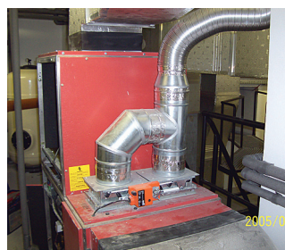
Kedvencünk: a kivitelező a használt levegő kidobó ágat összekötötte a frisslevegő beszívó ággal!
