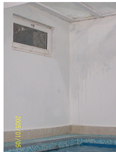
Hőhidak szerkezet miatt átázott fal
